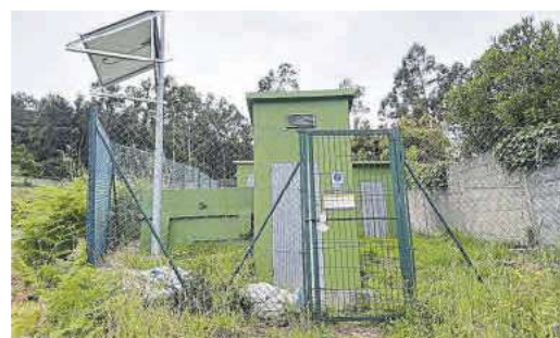
Depósito de agua en la carretera de Herbello.
